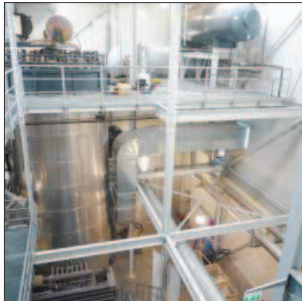
Im Inneren liefert eine Kesselanlage die Energie.
