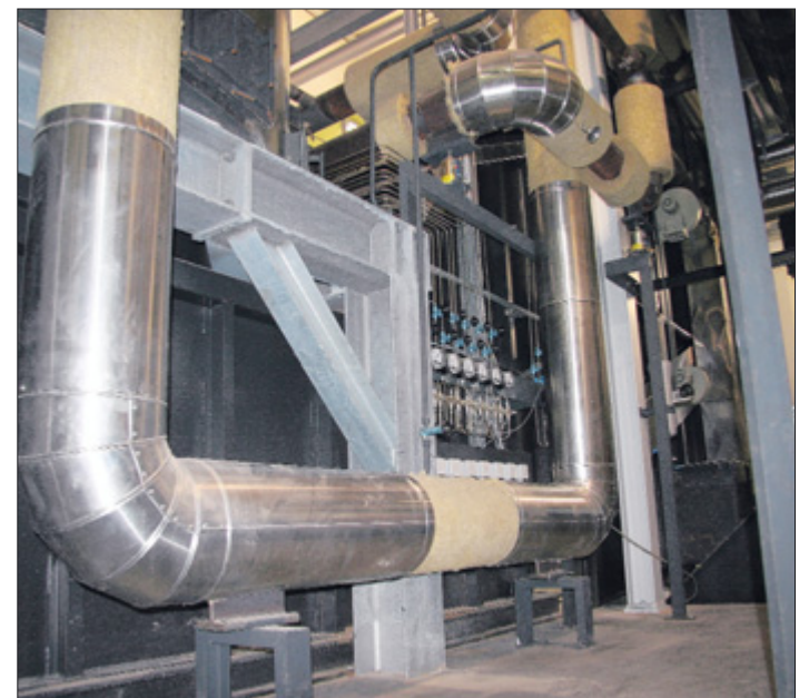
Innenleben des Heizwerks (Ausschnitt).
